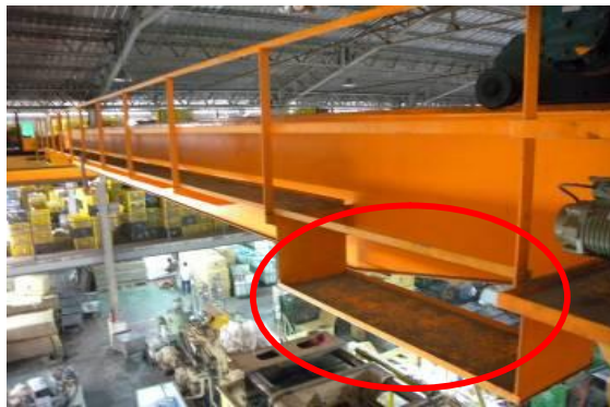
圖 1 走道與建築物結構空間不符規定處，降低部分走道高度
