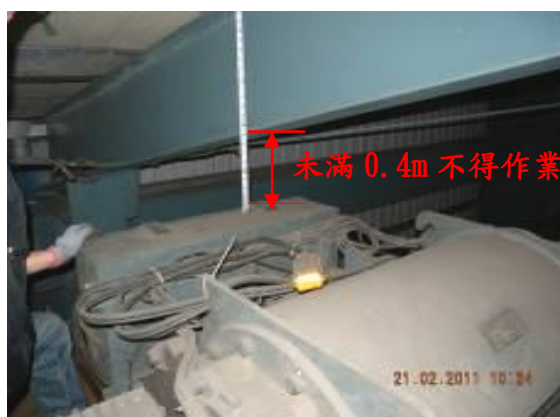
圖 4 吊運車在桁架終端位置與建築物間隔未滿 0.4 公尺， 應於維修時將吊運車移至桁架中間，使其間隔達 0.4 公尺以上，並設置連鎖裝置
